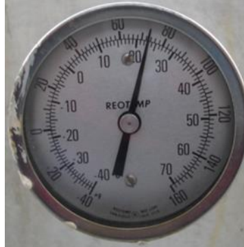
Figura 36. Dial de termómetro bimetálico en un tanque estacionario de GLP [90].
