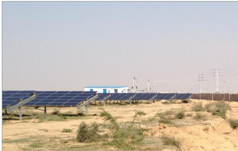
Foto N°9. Oficina y subestación
