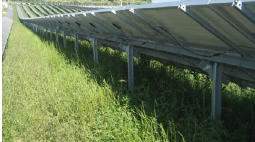
Figura 8. Foto de una instalación usando estructura fija
