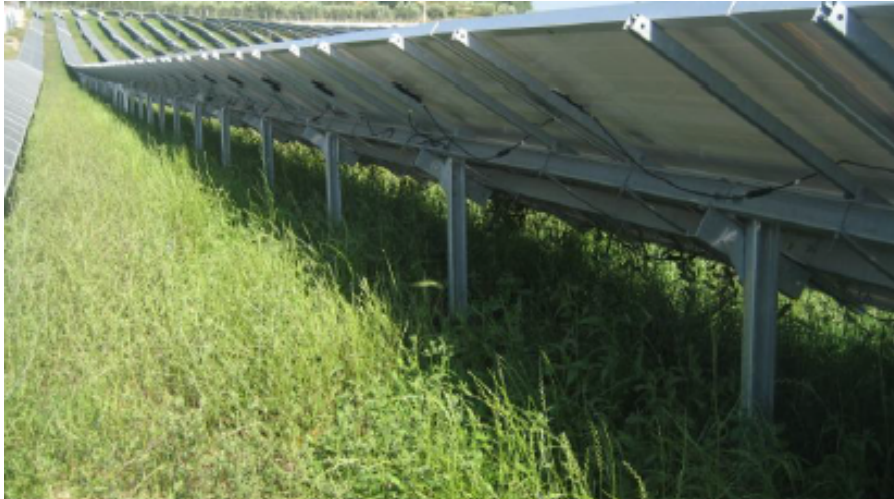
Figura 8. Foto de una instalación usando estructura fija
